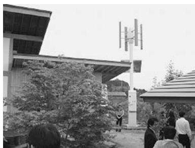
風切り音のない風力発電装置
