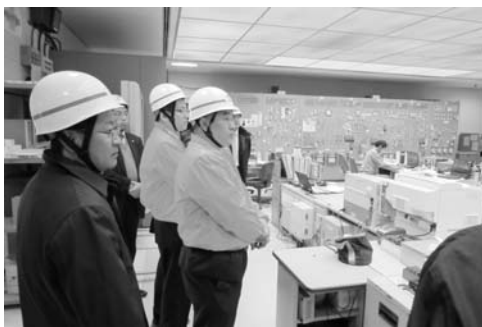
武豊火力発電所 中央制御室にて
