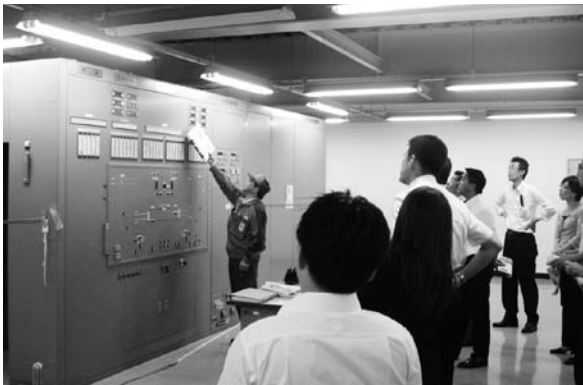
新信濃変電所での変電設備の説明
